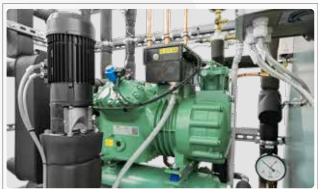
Stufenlos leistungsregelbarer Verdichter und frequenzgeregelter Hochleistungspumpe
