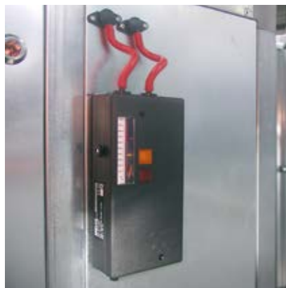
Paine-eroanturi (suodattimen valvonta)
