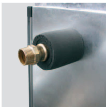
Doorvoering met Armaflex-isolatie
