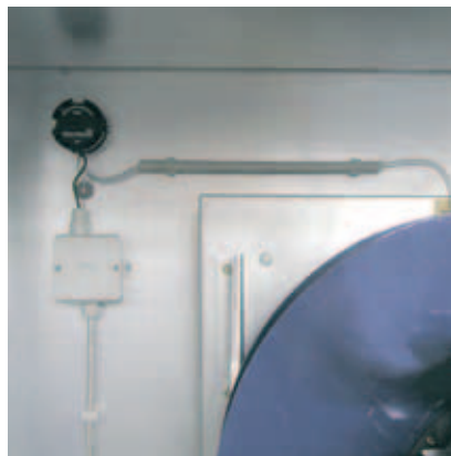
Volumestroommeting bij de ventilator
