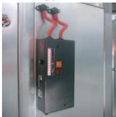
Differentiële manometer (filterbewaking)
