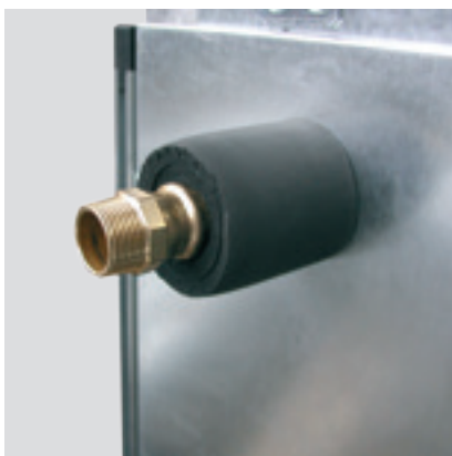
Vägggenomföring med Armaflex isolering
